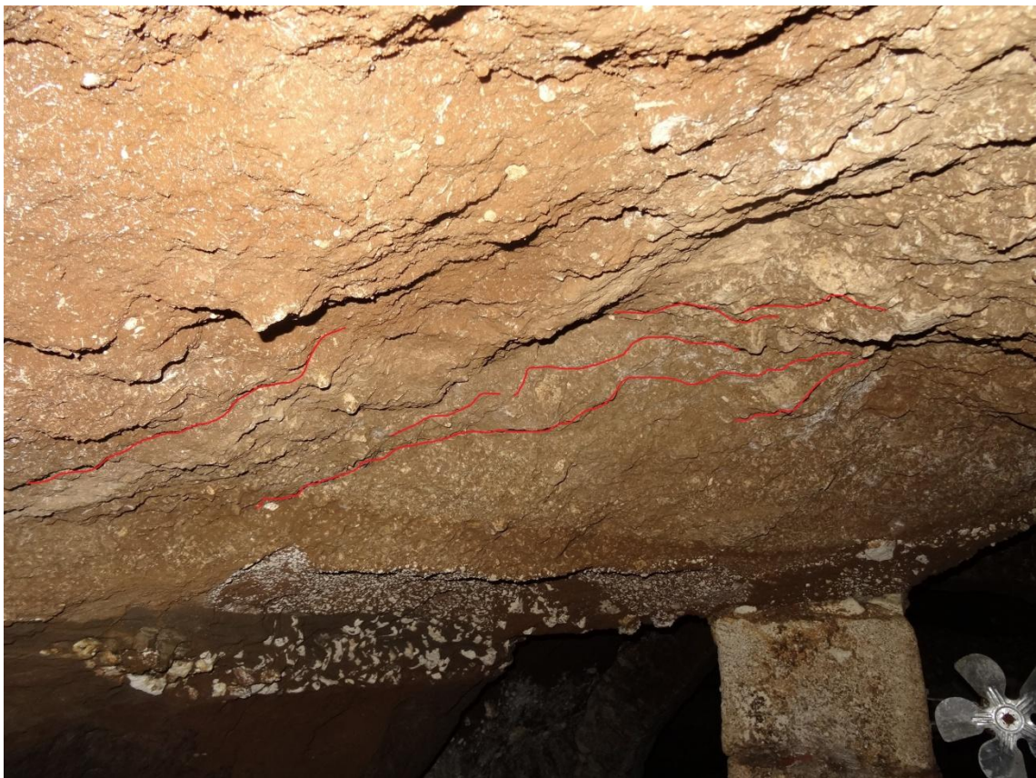
Distacchi e sfaldamenti (anche evidenziati) della cavità con accesso dall'aggregato 74B, denominata "Cavità A" nella relazione originaria in corrispondenza del muro su via Cavour
